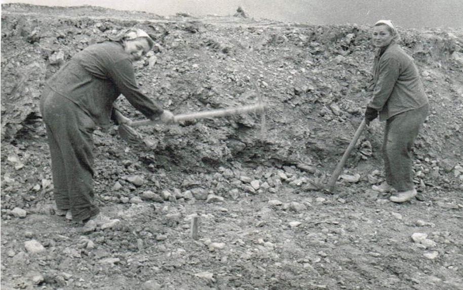
Anna Šupáková s Evou Kopčanovou počas výstavby verejného vodovodu v Trenčianskych Tepliciach.
